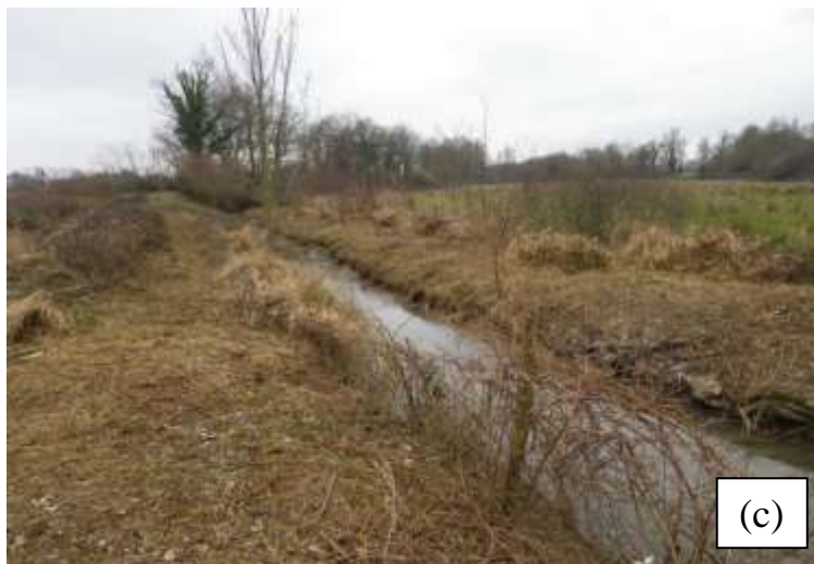
Figure 12 : illustration des différents types de travaux réalisés pour la restauration des fossés : a) reprofilage (curage) ; (b) restauration de la ripisylve (abattage, élagage, enlèvement des embâcles) ; (c) débroussaillage (Source : SRTC)
